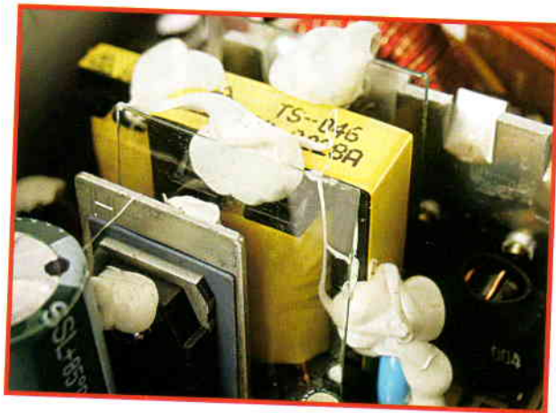
Bild 10. Folien zwischen Trafo und Kühlkörpern.
