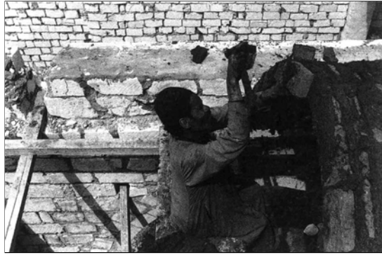
اعلي : عامل يقوم بالبناء في منزل جريس - 1982 - باستخدام الأساليب التقليدية و يلاحظ أن فتحي دمج استخدام الأحجار ( كما في الصورة ) مع الطوب في البناء.
